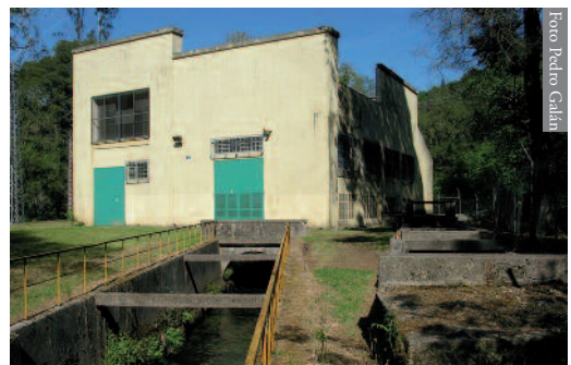
Figura S5: Central hidroeléctrica de Goimil (Vilarmaior), en cuyos muros vive una población aislada de I. monticola , próxima a la extinción en la actualidad. Depende de las rejillas de ventilación y grietas para refugiarse, no existiendo en el entorno hábitats adecuados para su supervivencia.
