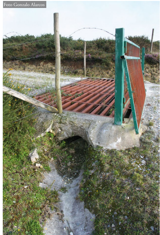
Figura 1: Ejemplo de modificación en paso canadiense con apertura de una de las paredes laterales para la salida de la fauna. Parque eólico en Cadavedo, Lugo.
